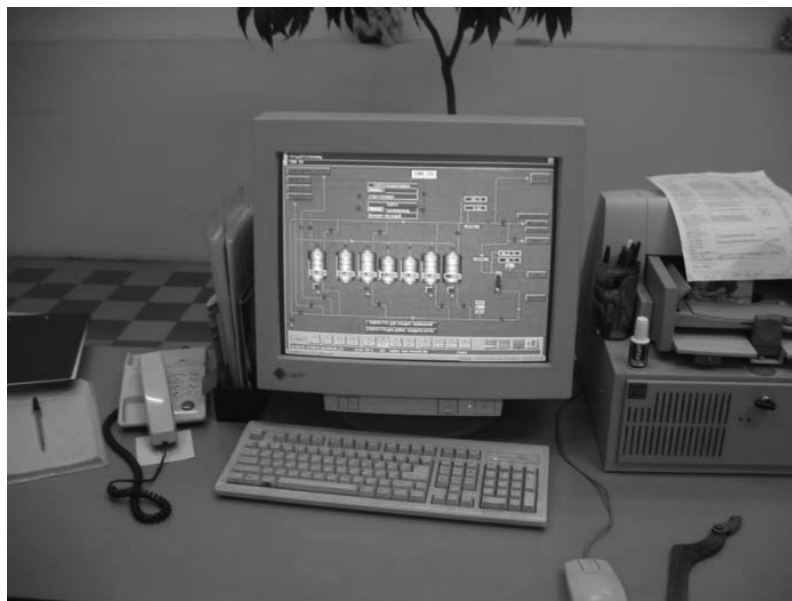
Рис. 2. Станция инженера и оператора
