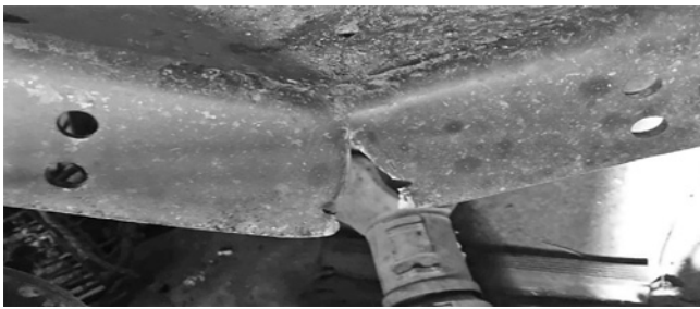
Рис. 4. Характерное повреждение поперечины рамы
