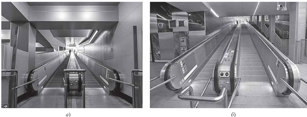
Рис. 1. Общий вид пассажирских конвейеров типа КП1 на станциях ГУП „Петербургский метрополитен“:
